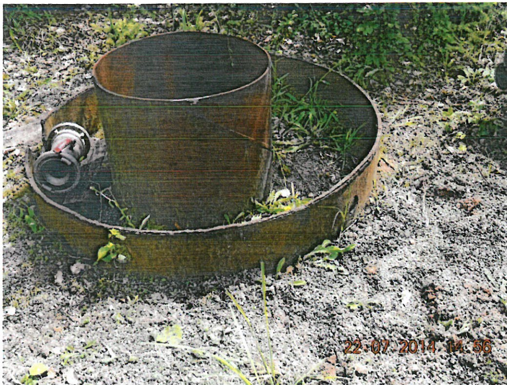
Abbildung 3-1: Geöffneter provisorischer Abschluss Brunnen TB 6
